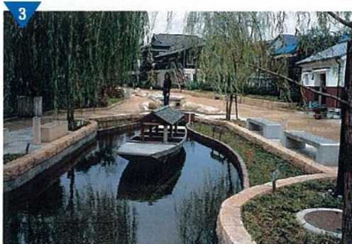
▲出口雨水幹線水緑景観モデル事業の整備(水面迴廊)(進行中)
